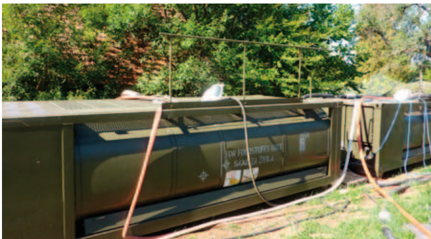
Cisterne za hrambo pitne vode; viden je napis Samo za živila.
